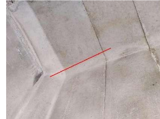
图 3-1：南奥特大桥右幅 R-3-3T 梁：距 3 号墩 0m 处，左翼缘板纵向裂缝；数量：1 条，长度：0.5m，宽度：0.13mm。
