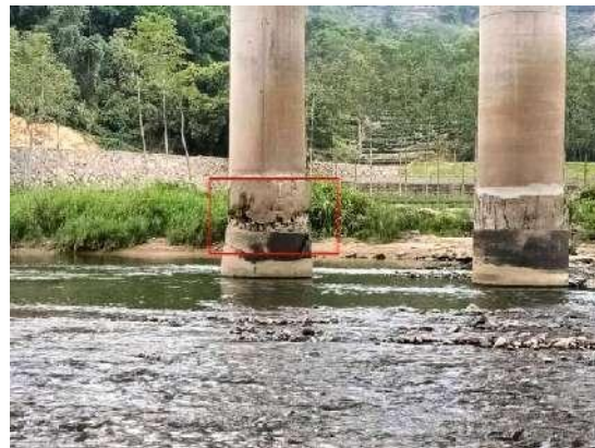
图 3-9: 武曲特大桥右幅 DS-R-15-1D 墩身: 距下缘 1m 处, 大桩号面剥落露筋; 数量: 1 处, 长度: 1.5m, 宽度: 0.4m。
