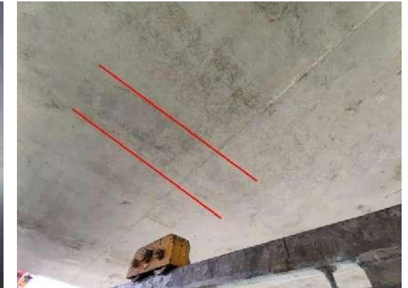
图 3-4：西浦大桥左幅 L-2-2-13 箱梁：距右侧 2m 处，梁底纵向裂缝；数量：2 条，长度：0.8m，宽度：0.13mm。
