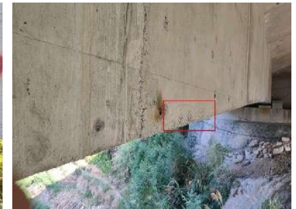
图 3-6：西浦大桥右幅 左幅 R-1-1-12 箱梁：距下缘 0m 处，右腹板蜂窝、麻面；数量：1 处，长度：0.3m，宽度：0.1m。
