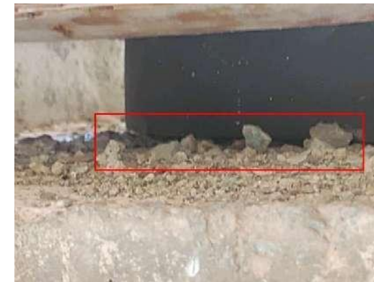
图 3-13: 武曲特大桥右幅 ZZ-R-6-6-5 支座: 小桩号面脱空; 数量: 1 个, 高度: 0.01m, 百分比: 30%。
