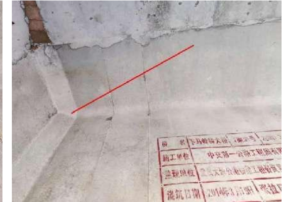
图 3-2：南奥特大桥右幅 R-4-3T 梁：距 4 号墩 0m 处，左翼缘板斜向裂缝；数量：1 条，长度：1.3m，宽度：0.13mm。
