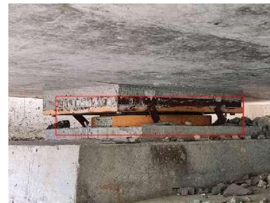
图 3-12: 武曲特大桥左幅 ZZ-L-34-33-4 支座: 大桩号面横向开裂; 数量: 1 条, 长度: 0.3m, 宽度: 1mm。
