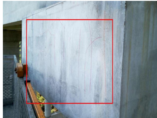
图 3-7: 西浦大桥左幅 GL-L-5D 盖梁: 左侧网状裂缝; 数量: 1 条, 长度: 2m, 宽度: 1mm。
