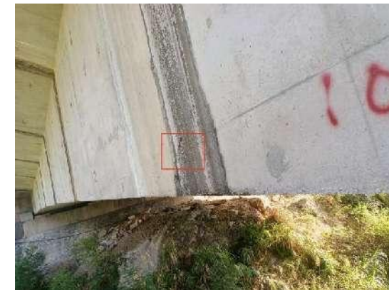
图 3-5：西浦大桥右幅 R-1-1-10 箱梁：右腹板露筋；数量：1 处，长度：0.1m。
