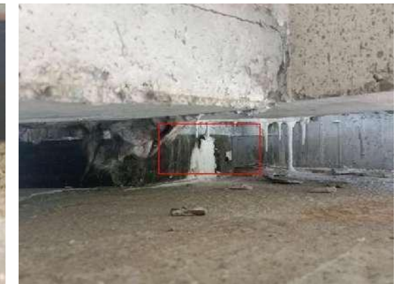
图 3-14: 武曲特大桥右幅 ZZ-R-22-22-1 支座: 小桩号面位置串动; 数量: 1 个, 位移: 0.05m。
