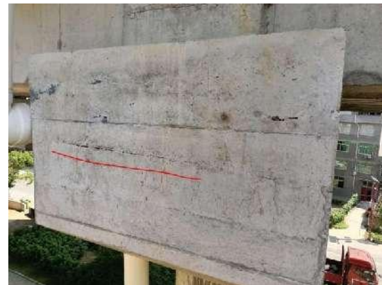
图 3-10: 武曲特大桥右幅 GL-R-24D 盖梁: 右侧露筋; 数量: 1 处, 长度: 0.6m。
