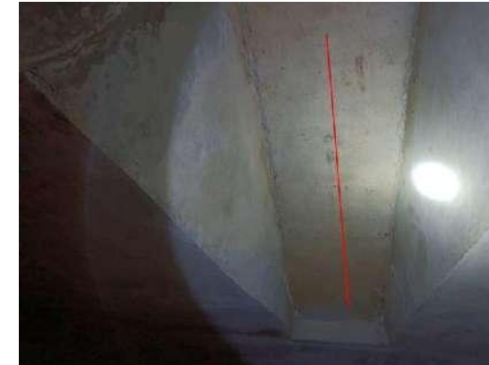
图 3-3：西浦大桥左幅 L-1-1-12 箱梁：距右侧 4m 处，梁顶纵向裂缝；数量：1 条，长度：2m，宽度：0.13mm。
