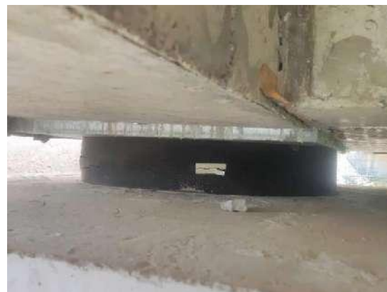
图 3-11: 西浦大桥右幅 ZZ-R-15-15-5 支座: 横向开裂; 数量: 1 条, 长度: 0.2m, 宽度: 2mm。
