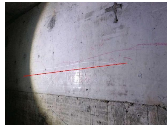
图 3-2: 交溪特大桥右幅 R-7 箱梁: 距 6 号墩 77.5m 处, 右腹板纵向裂缝; 宽度: 0.14mm, 数量: 1 条, 长度: 1m。
