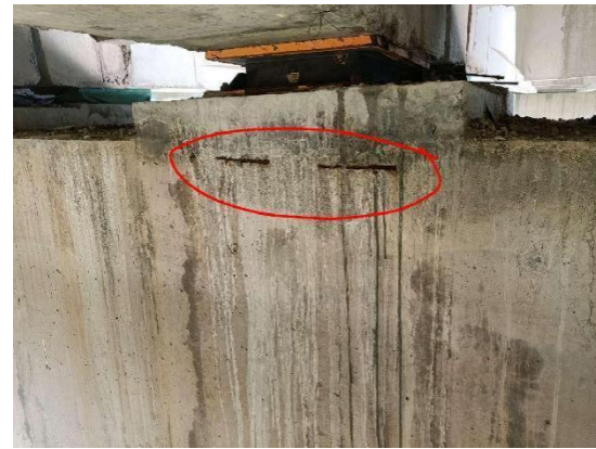
图 3-10: 交溪特大桥左幅 GL-L-8D 盖梁: 距左侧 1m 处, 小桩号面露筋; 数量: 1 处, 长度: 0.8m, 宽度: 0m。
