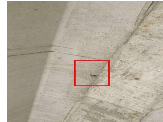
图 3-5: 交溪特大桥左幅 L-3-5T 梁: 距 3 号墩 4m 处, 右翼缘板破损露筋; 数量: 1 处, 长度: 0.2m, 宽度: 0.1m。
