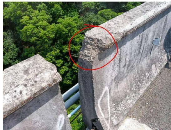
图 3-11: 交溪特大桥（上行） R-HL-R-1 右侧护栏: 3 号墩顶桥面剥落; 数量: 1 处, 长度: 0.2m, 宽度: 0.2m。
