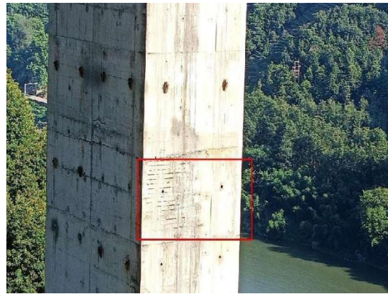
图 3-9: 交溪特大桥右幅 DS-R-8-1D 墩身: 距左侧 0m 处, 距上缘 4m 处, 墩身露筋; 数量: 10 处, 长度: 1m, 宽度: 0m。
