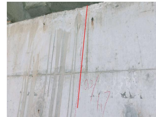
图 3-7: 交溪特大桥左幅 GL-L-5D 盖梁: 距右侧 3.5m 处, 小桩号面竖向裂缝; 数量: 1 条, 长度: 1.7m, 宽度: 0.2mm。
