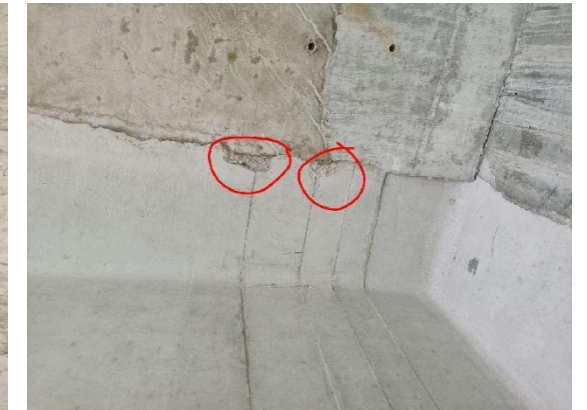
图 3-6: 柯洋大桥右幅 R-2-4T 梁: 距 1 号墩 1m 起, 左翼缘板剥落; 数量: 2 处, 长度: 0.2m, 宽度: 0.2m。
