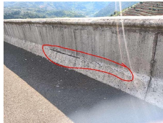
图 3-12: 柯洋大桥（上行） R-HL-R-1 右侧护栏: 距 4 号墩顶 15m 处露筋; 数量: 1 处, 长度: 1.5m, 宽度: 0.05m。
