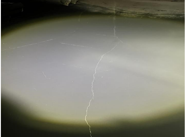
图 3-6 BK2945+969 衬砌 拱顶（全幅） 横向裂缝 L=20m,W=0.68mm
