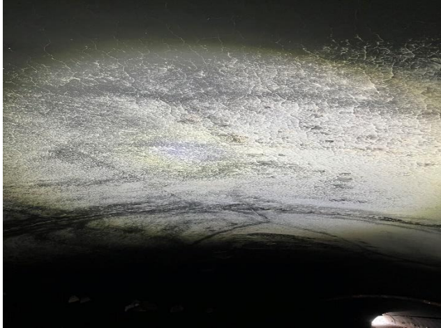
图 3-7 BK2945+968-951 衬砌 拱顶 网状裂缝 S= (17×8) m²,Wmax=0.21mm
