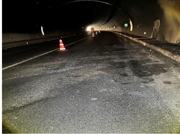
图 3-12 BK2945+968-958 路面 主车道 沥青路面烧伤 S= (10×4) m²
