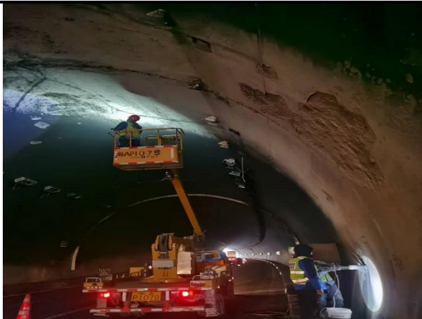
图 3-2 二次衬砌表层脱落
