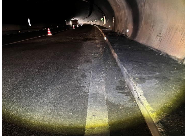
图 3-14 BK2946+975~955 标志 路面中线、右侧轮廓线烧伤 L=20m
