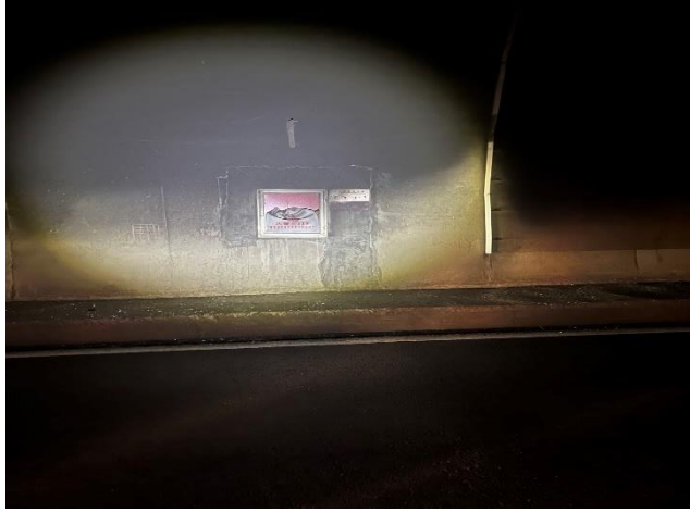
图 3-15 BK2945+948 衬砌 左边墙 H=1.5m 消防栓熔毁 1 个
