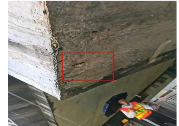
图 3-12: 溪柄特大桥(上行) GL-1D 盖梁: 距下缘 0m 处, 右侧剥落; 数量: 1 处, 长度: 0.2m, 宽度: 0.1m。
