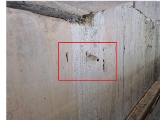
图 3-9: 建安 2#高架桥(下行) GL-L-10D 盖梁: 距右侧 5m 处, 小桩号面露筋; 数量: 3 处, 长度: 0.2m。
