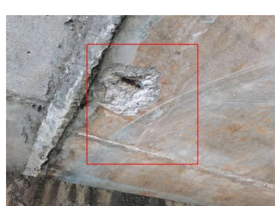
图 3-8: 溪柄特大桥(上行) 1-5 空心板: 距 0 号墩 0m 处, 板底露筋; 数量: 1 处, 长度: 0.3m。
