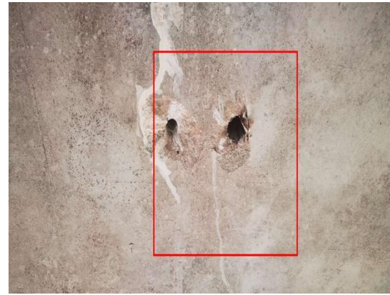
图 3-4: 建安关高架桥(上行) 4-3-8 箱梁: 距 4 号墩 58m 处, 距右侧 1m 处, 梁底, 剥落; 数量: 2 处, 长度: 0.1m, 宽度: 0.1m。
