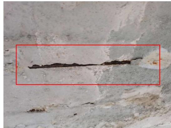
图 3-7: 建安 2#高架桥(下行) 3-2-4 箱梁: 距 2 号墩 15m 处, 距左侧 1m 处, 梁底露筋; 数量: 3 处, 长度: 0.4m。
