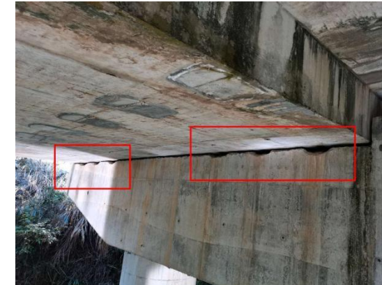
图 3-11: 九沙溪高架桥(下行) GL-27D 盖梁: 距小桩号面 0m 处, 小桩号面破损; 数量: 6 处, 长度: 0.5m, 宽度: 0.5m。
