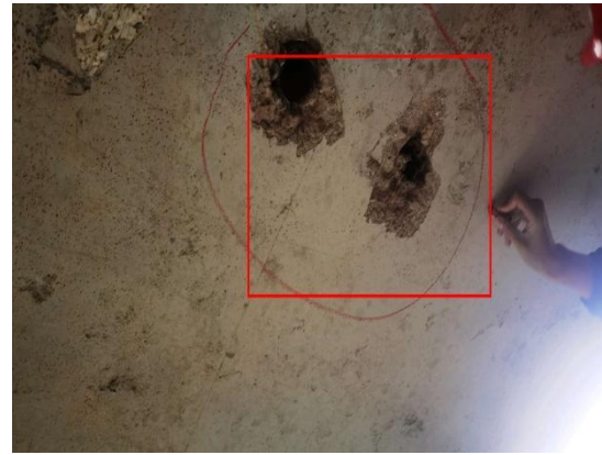
图 3-3: 建安关高架桥(上行) 1-1-6 箱梁: 距 0 号台 20m 处, 距右侧 1m 处, 梁底, 剥落; 数量: 2 处, 长度: 0.1m, 宽度: 0.1m。
