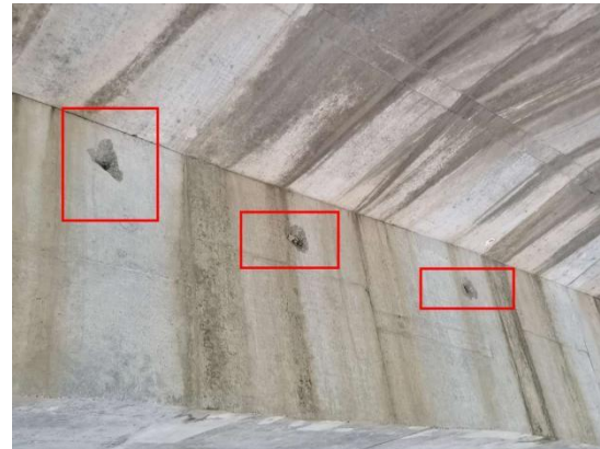
图 3-5: 九沙溪高架桥(下行) 23YFBT 梁: 距 23 号墩 18m 处, 右腹板剥落; 数量: 3 处, 长度: 0.3m, 宽度: 0.3m。
