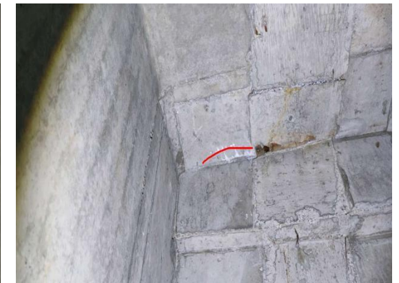
图 3-2：建安关高架桥（上行）23-4T 梁：距 23 号墩 0m 处，右翼缘板斜向裂缝且析白；数量：1 条，长度：0.2m，宽度：0.12mm。
