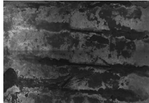
图 3-1 豪岭下行隧道 BK187+163 左边墙 0.46 米～1.8 米 钢筋锈胀 S=2.23 m²
