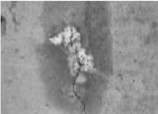
江家渡隧道下行 BK31+880 左边墙 1.39 米～1.43 米 纵向裂缝，L=1.8m，W=0.37mm
