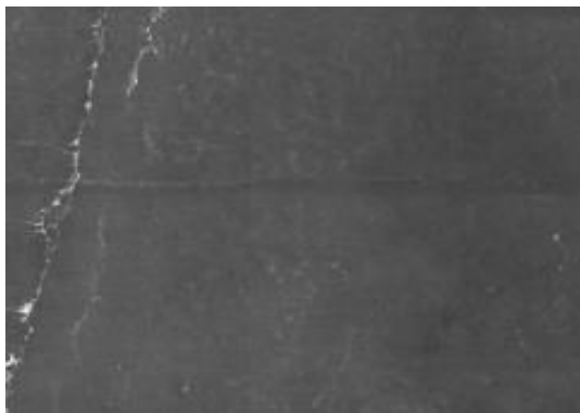
吉坑隧道上行 AK1873+016 右拱顶 6.30 米~ 6.76 米 斜向裂缝 L=9.1m, W=0.62mm
