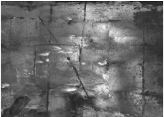
泉南高速公路泉州泉三段隧道 右边墙 1.09 米~1.50 米 钢筋外露 S=0.50 m²
