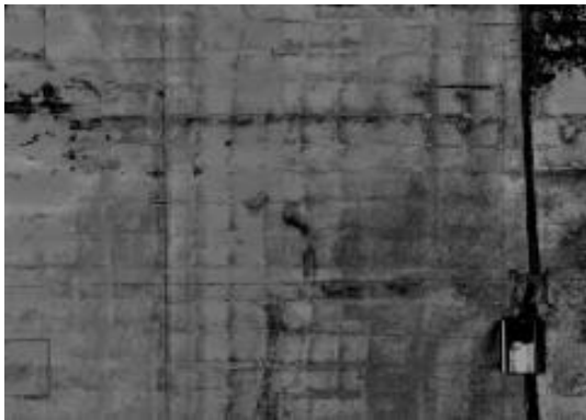
泉南高速公路泉州泉三段隧道 右拱腰-右 拱顶 3.02 米~5.91 米 钢筋外露 S=10.26 m²
