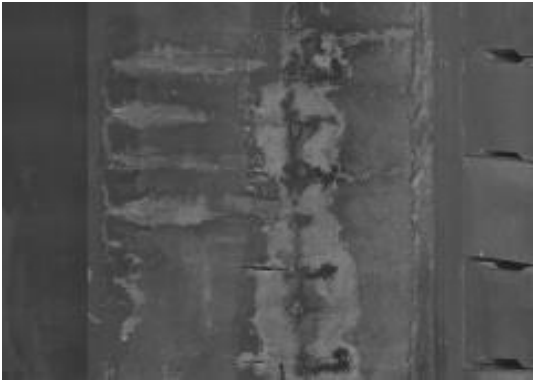
泉南高速公路泉州泉三段隧道 左边墙 1.05 米~1.66 米 钢筋外露 S=1.46 m²
