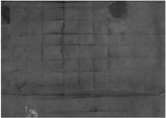
泉南高速公路泉州泉三段隧道 右拱顶 5.64 米~6.09 米 斜向裂缝 L=2.1m, W=0.34mm
