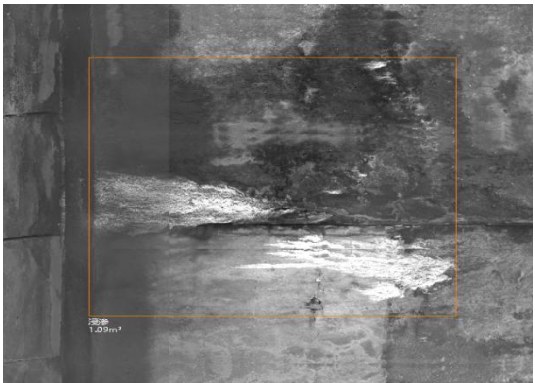
新岭格隧道上行 AK93+089 右边墙 0.00 米~ 0.35 米 浸渗 S=1.09 m²
